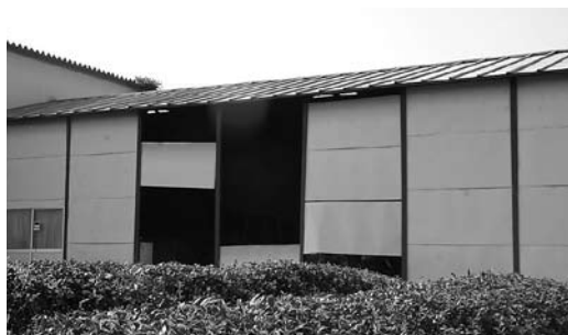
写真1 突風の被害（磐田市広野）
